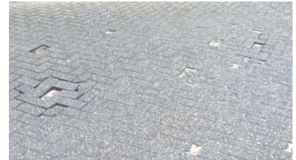
De toplaag van de bestrating is op veel plekken volledig versleten, de stenen moeten vervangen worden.
